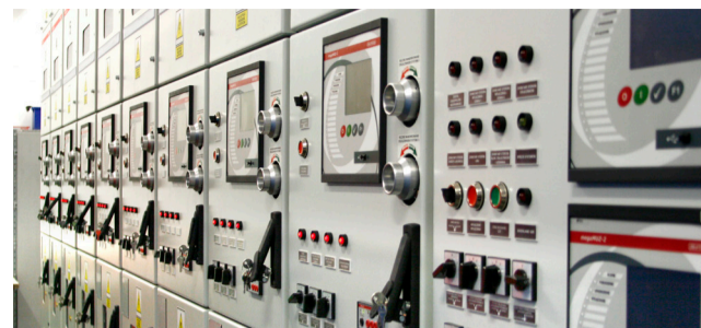
► BEZPIECZNA AUTOMATYKA: Efektem projektu realizowanego przez JM-Tronic będzie bezobsługowa cyfrowa rozdzielnica SN.
